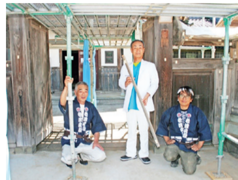
写真2 門を解体する時に匠から声をかけられ、ご当主から最初木材を解体してほしいと泣いたが（全国の文化財修復のため飛び回っている松浦建設の匠たちと共に）
