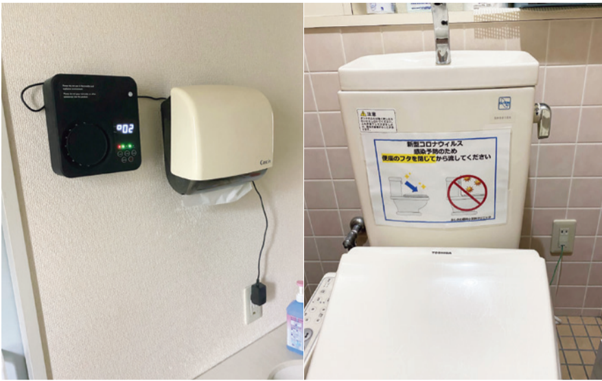
トイレの人感式低濃度オゾン発生装置（左写真）と「ふたを閉じてからお流しください」の案内
