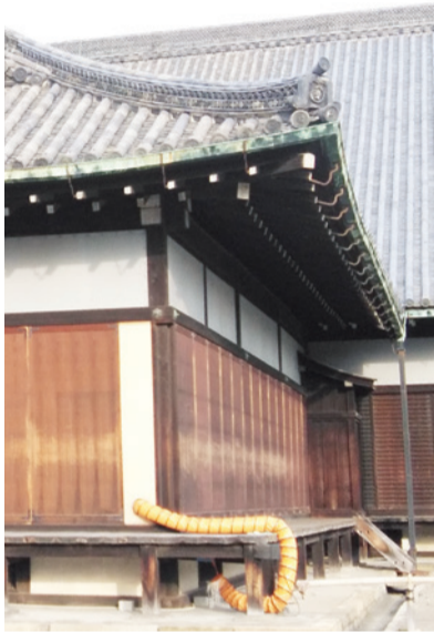
京都二条城の排気ダクト
