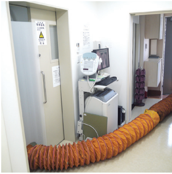
多賀クリニックの排気ダクト
